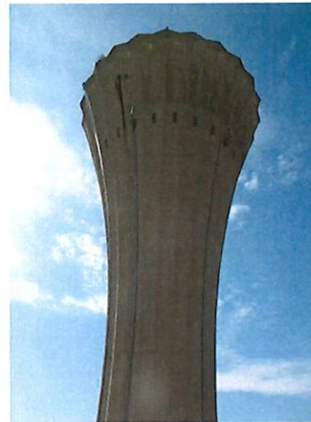
7 réservoirs dont le château d'eau des Boiffiers
